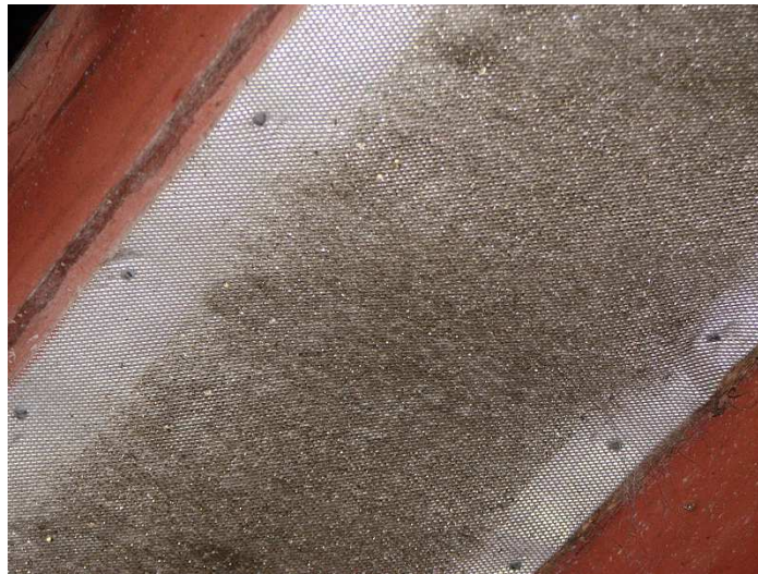
Figur 40. Insektsnät placerad i tilluften på ett stall. Redan efter något år är nätet igensatt.
