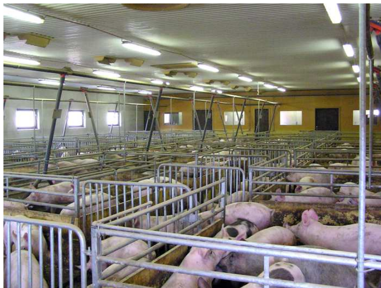
Figur 29. Exempel på slaktsvinstall med luftintag placerade i taket. Luften tas in via vindsutrymmet ovanför stallet.
