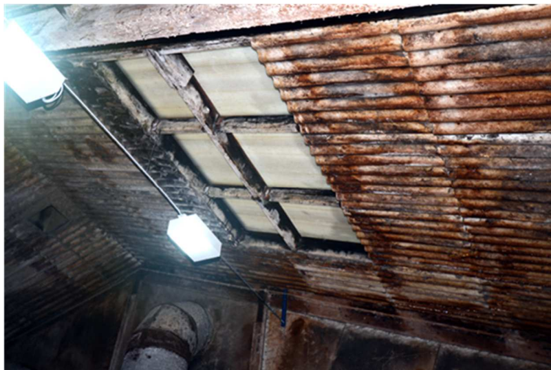
Figur 16. Lösdriftsladugårdar från sextio och sjuttio-talet är ofta i mycket dåligt skick med allvarliga fukt och korrosionsskador
